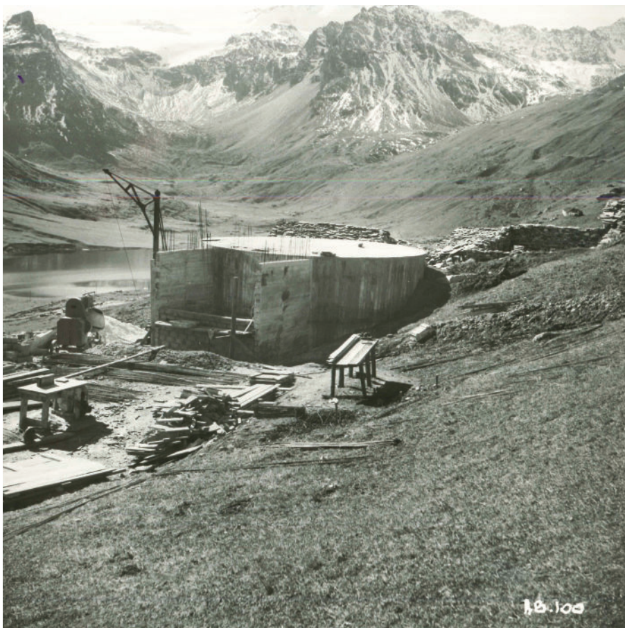
Réservoir d'adduction d'eau des Almes.
