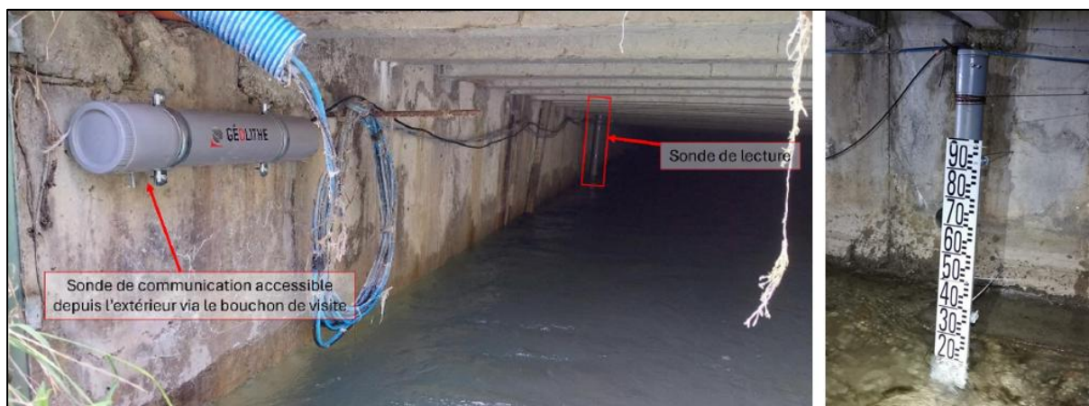
Figure 10: station hydrologique en aval de la grille à l'exutoire du lac de Tignes
