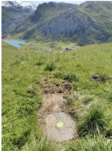
Point particulier R-telecom – regard sur réseau sec _07/2025 Vue vers le bas
