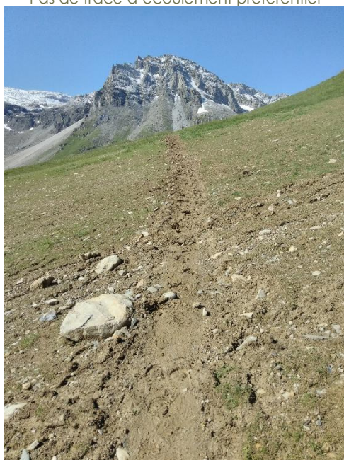
Point particulier n°1bis – Traversée de sentier _07/2025 Aucun aménagement pour le passage d'écoulement (pas de busage ou cunette)
