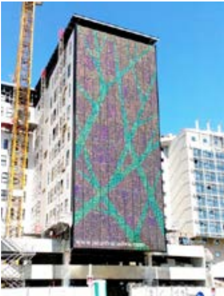
Mur rideau en panneaux photovoltaïques, Jaiuntrucadire.com, 2015
